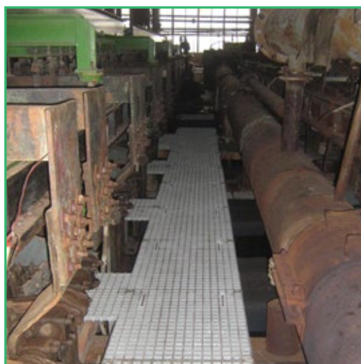
Мостик из стеклопластика для обслуживания электролизного оборудования
