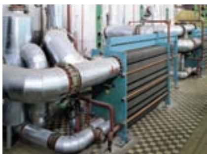
Две системы AlfaVar, установленные в качестве бустера на 2-й и 3-й эффекты выпарной установки сахарорафинадного производства.
