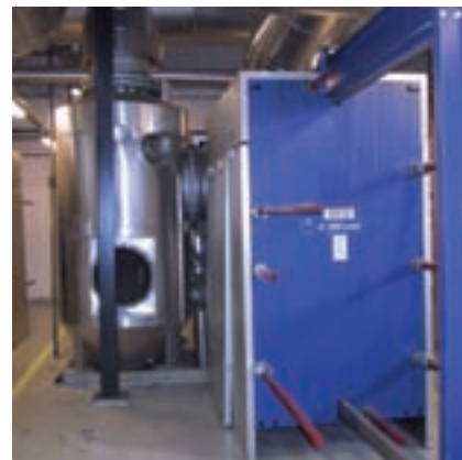
AlfaVar используется в выпарной системе с механической рекомпрессией для упаривания барды на заводе по производству технического этанола.
