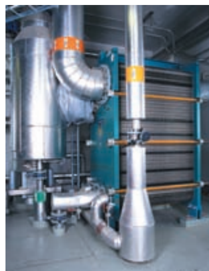
Конденсатор этанола. Компания Absolut (Швеция). Все колонны компании Absolut на дистиляционном заводе в г. Bhus имеют ребойлеры и конденсаторы компании Альфа Лаваль. Аппараты Альфа Лаваль были выбраны в связи с их компактностью.
