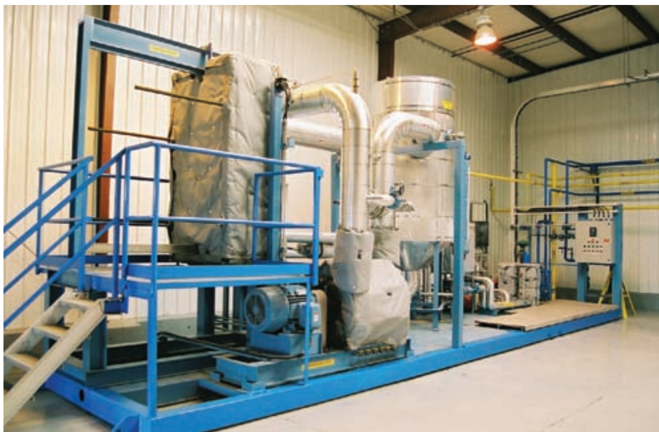
Выпарная установка с MVR для выпаривания подсолённых сточных вод. Корпорация Newalta (Канада). Путём выпаривания подсолённых сточных вод компания Newalta значительно снизила количество стоков и получила возможность повторного использования в производстве свежей дистиллированной воды. Aqua Pure, канадская проектная организация, построила эту уникальную запатентованную MVR систему, которая обеспечила лучшую термическую эффективность и меньшее засорение по сравнению с традиционной кожухотрубной установкой.
