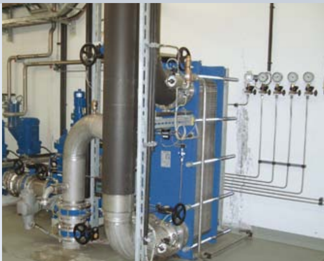
Охлаждение масла для гидросистем на электростанциях
