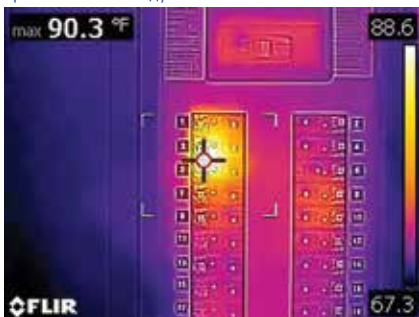
Область с горячим участком указывает на работающий плавкий предохранитель
