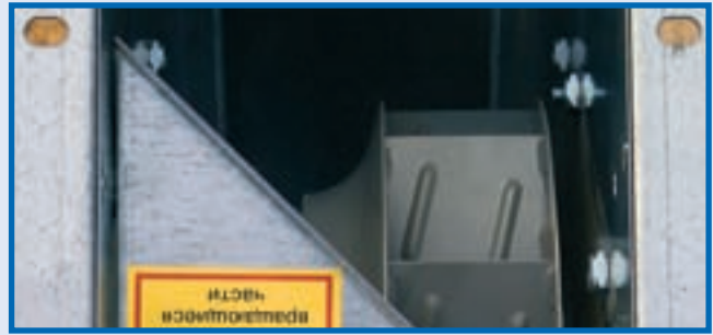
Рис. 2 Перемычка («язык») на выходе вентилятора GTLB
