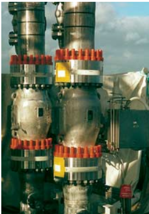
Клапаны регулирования расхода 12" ANSI 600 на газоизмерительной станции, Германия
