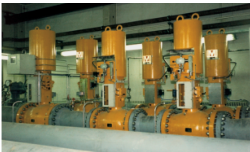
Клапаны регулирования давления 20" ANSI 600 и предохранительные отсечные клапаны 16" ANSI 600 на газоизмерительно-редукционной станции, Германия
