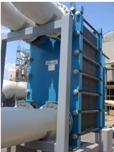
Эти пластинчатые теплообменники Tranter установлены на электростанции смешанного цикла, работающей на природном газе в США в качестве охладителя замкнутой системы охлаждения.
